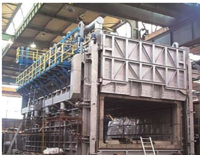
Stoßofen herkömmlicher Bauart
