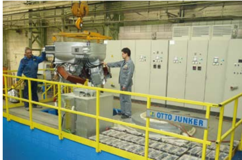
Inbetriebnahme der neuen Sinter- und Aufheizanlage
